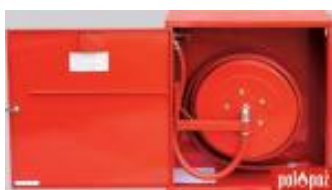
Hydrant wewnętrzny 25 z węzłem półsztywnym.
